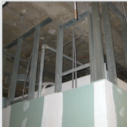
عدم امتداد یافتن پنل‌ها تا سقف اصلی
