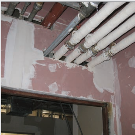
عدم رعایت الزامات کد حریق
